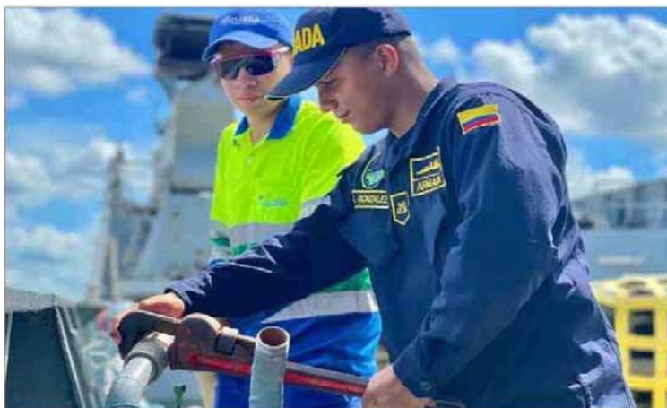
En la imagen Aqualia está suministrando agua potable al buque ARC Golfo de Urabá.
