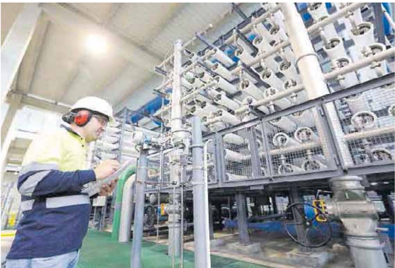
Un operario toma mediciones en las instalaciones de la desaladora de Orpesa-Cabanes, en una foto de archivo.
